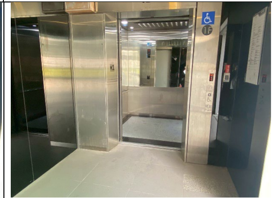
創研大樓無障礙電梯
