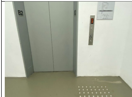
卓越大樓無障礙電梯
